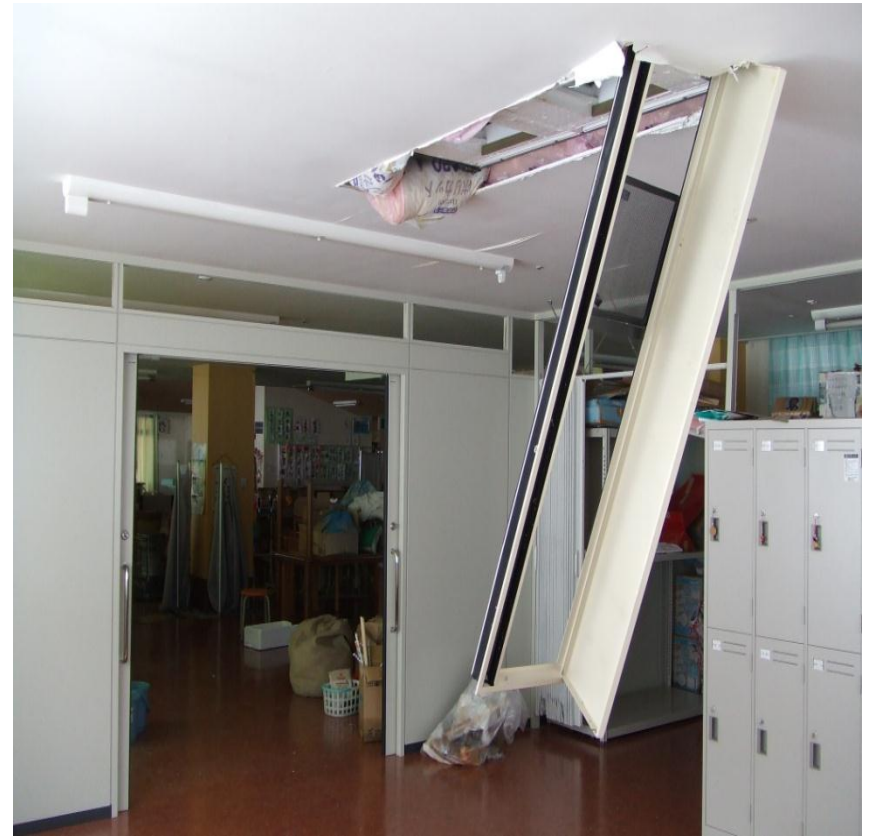
天井から落ちた空調の吹き出し口
